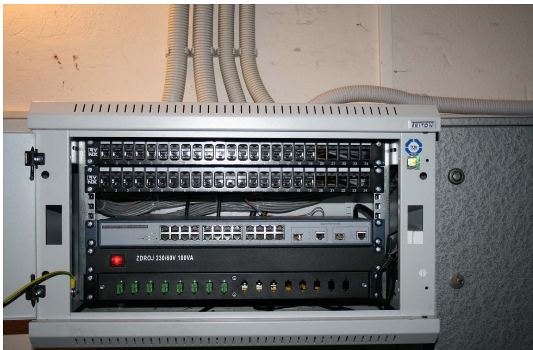
Obr.3: Detailní zapojení domovních přepínačů s dálkovým napájením a optickou vanou.
